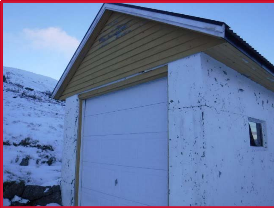
Bilde 29 - Industriport i garasje ved dam, bygg 2
