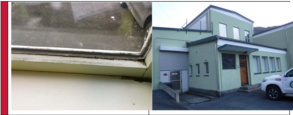
Bilde 20 - Isolerglassvindu som inneholder asbest. Asbestholdige fraksjoner saneres forskriftsmessig av autorisert firma.
