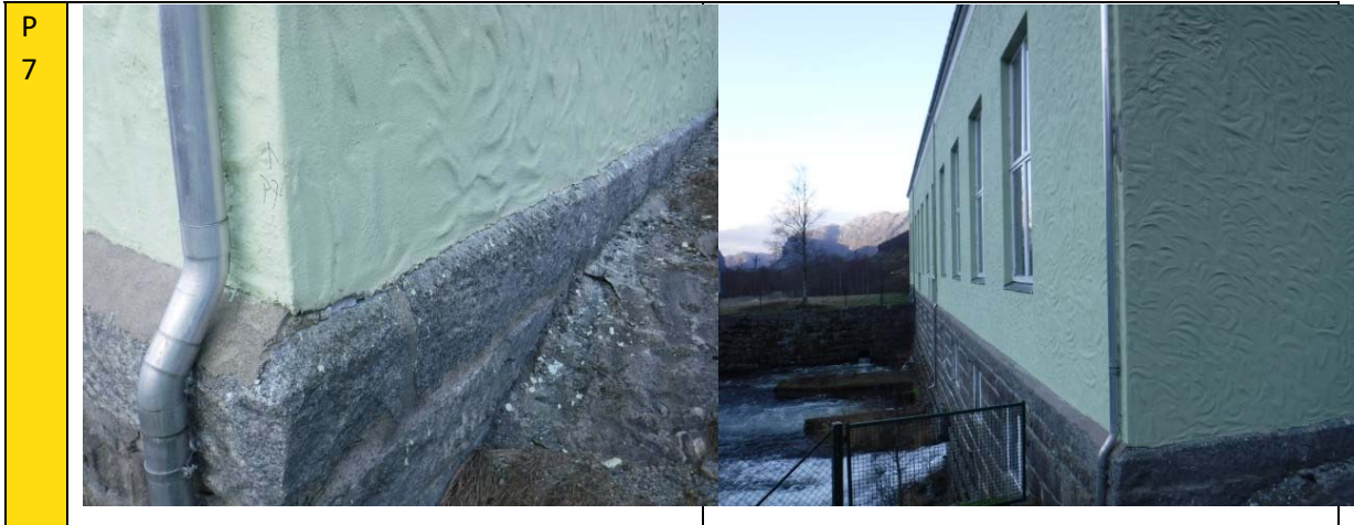
Bilde 42 - Materialprøver av maling, hvor fargekoding viser forurensningsgrad; rød (farlig avfall) og oransje (lavforurenset avfall).
