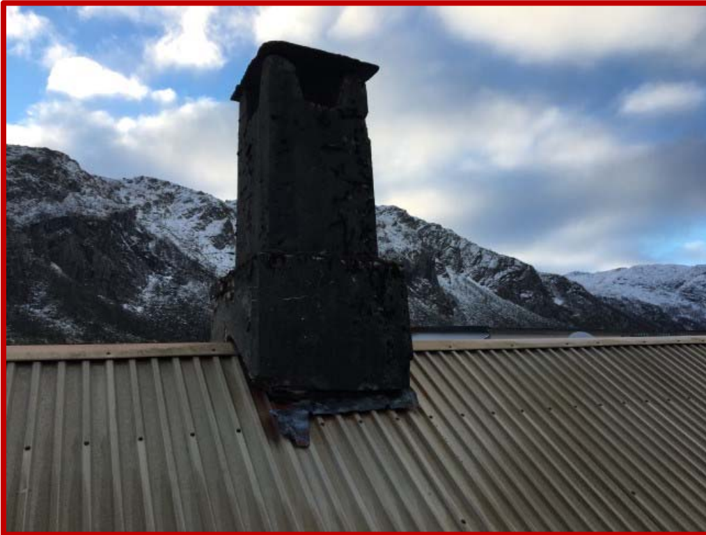
Bilde 38 - Blybeslag på pipe i uthuset, bygg 6
