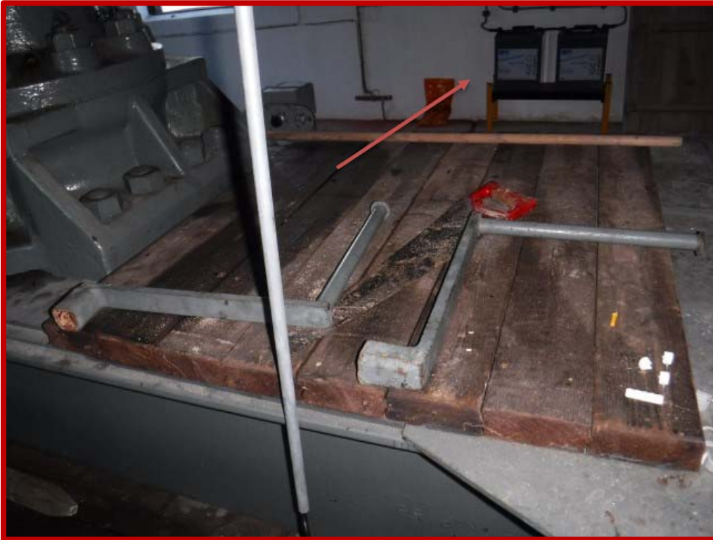
Bilde 36 - Batterier i lukehus ved dam, bygg 1
