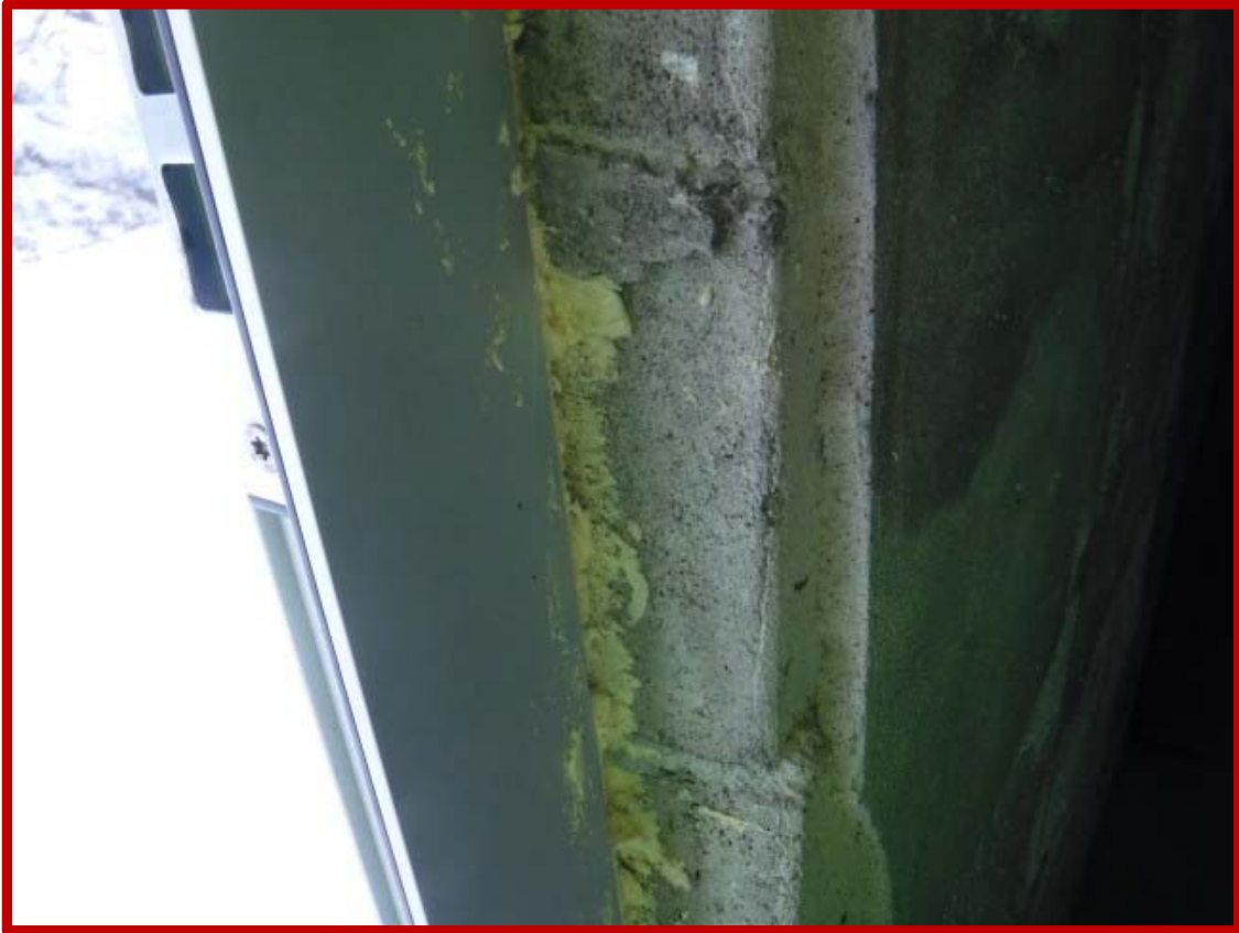
Bilde 28 - PUR-skum i forbindelse med ytterdør i garasje ved dam, bygg 2. PUR-skum sorteres i egen fraksjon og leveres godkjent mottak for farlig avfall.
